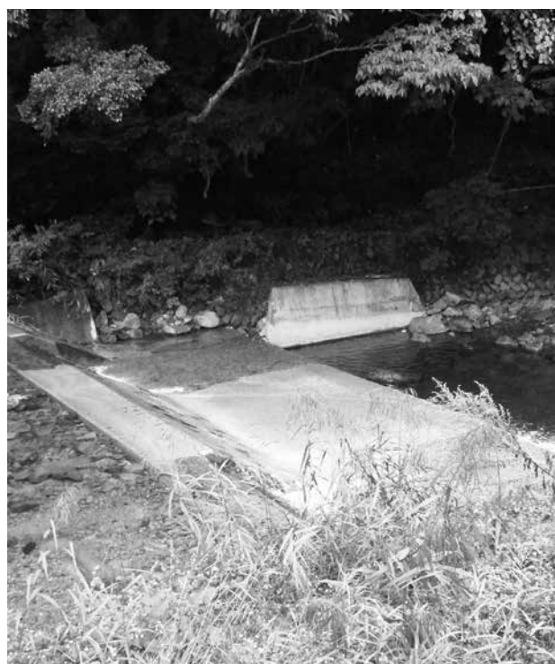
水害対策に護岸の整備が必要
