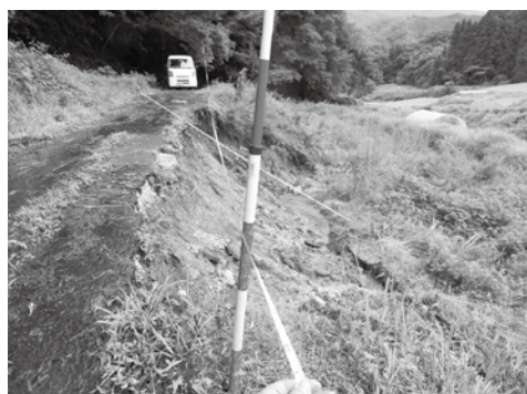
被害を受けた黒坂地区農道（小河内）
